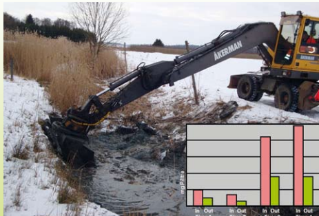
ODLING I BALANS EXPÉRIMENTE LA MISE EN PLACE DE BARRAGES AFIN DE RÉDUIRE LES REJETS DE PHOSPHORE.
